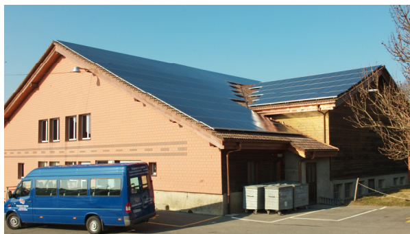
233 m2 installés sur la Grande salle communale
