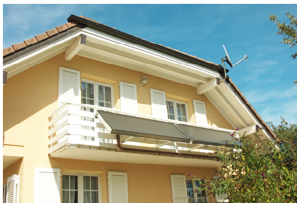
capteurs solaires thermiques disposés plein sud sur un balcon de villa
